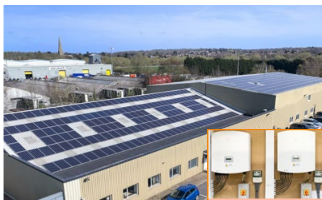
Grundfos Rooftop, UK 123.4kW
