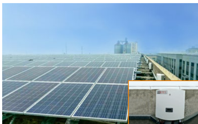
Changzhou Vaillant 2MW
