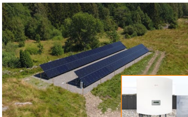
Västra Götaland, Sweden 43.31kW
